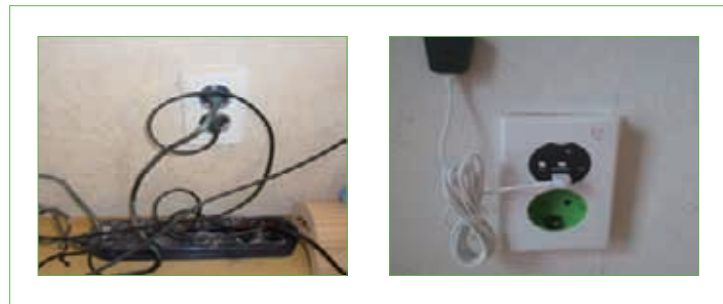
가전제품에 흐르는 미세한 전기의 낭비를 억제하여 세대 내 에너지 절감
